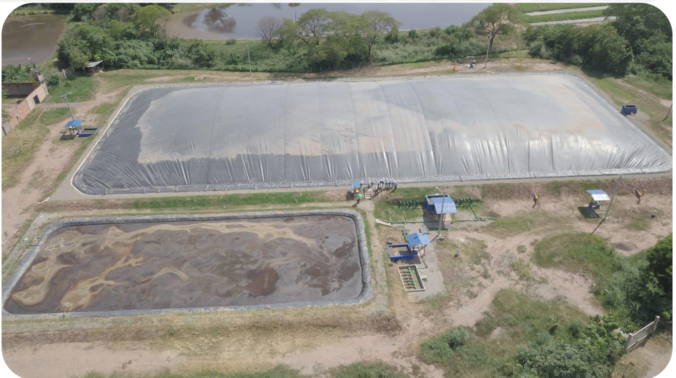
Vista aérea — laguna de biogás con geomembrana y sistema de captación
