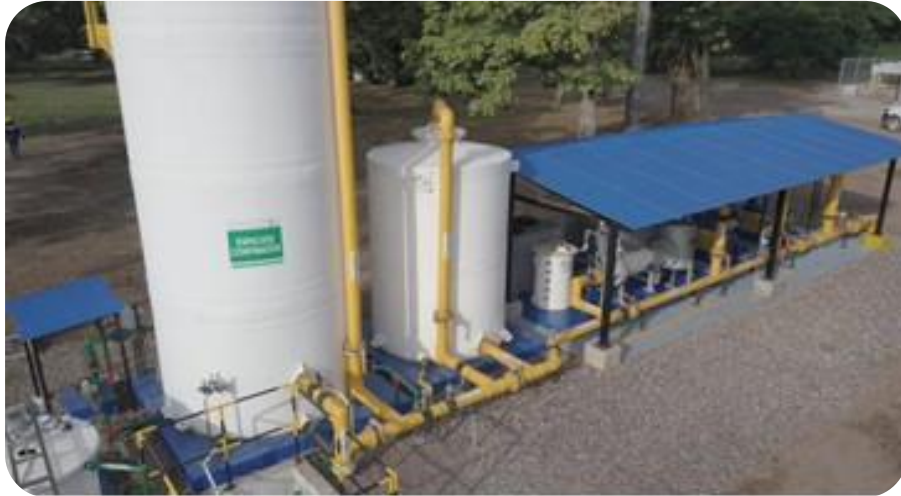
Sistema de acondicionamiento y distribución de biogás — instalación NOVATIO
